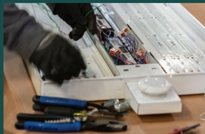
Inštalácia úsporného osvetlenia v rámci programu Prologis Essentials LED.
